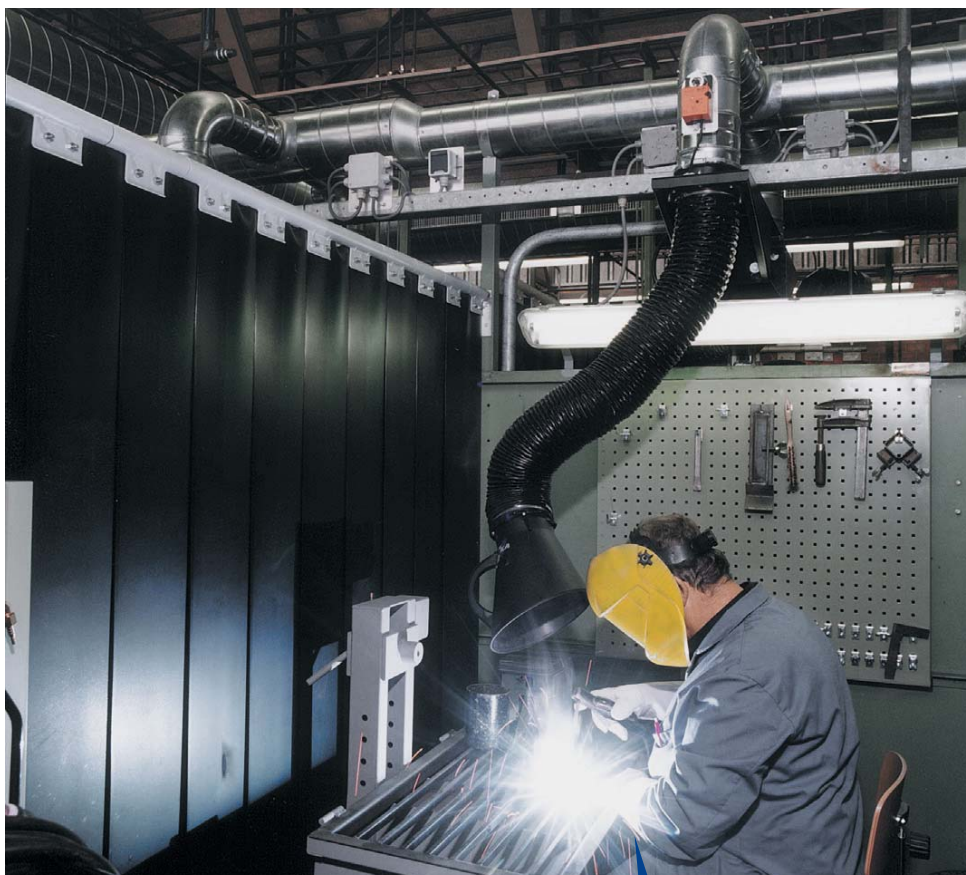
Anwendungsbeispiel: Teleskop-Absaugarm in Schweißkabine
