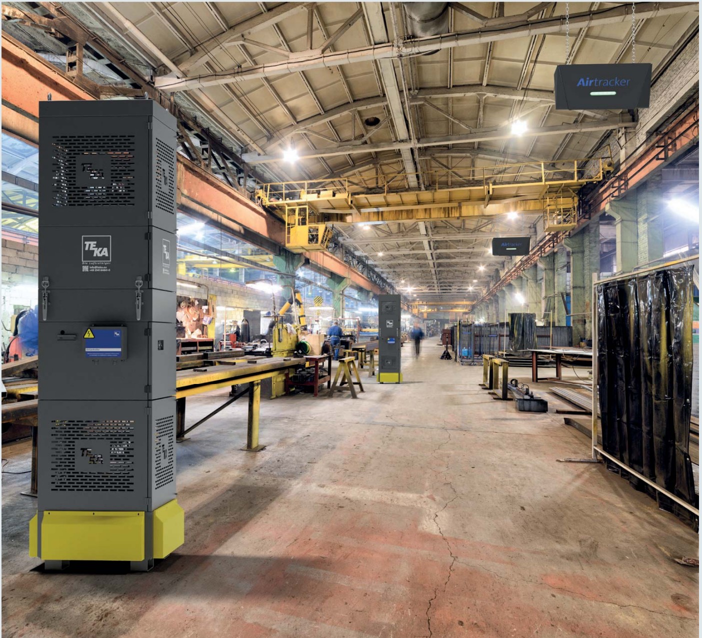
Exemple d'application CleanAirCubes avec Airtrackers
